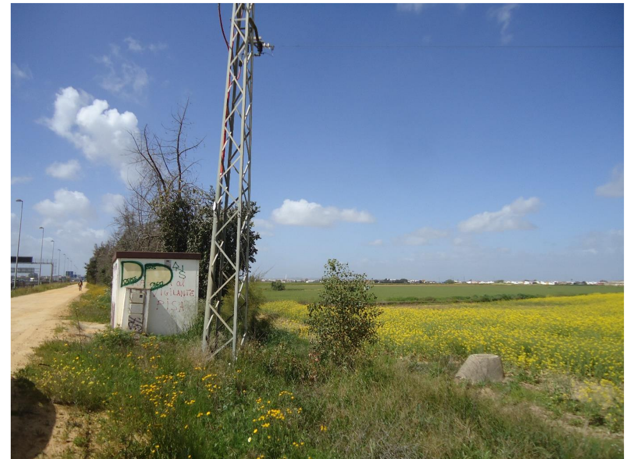
Figura 2 Posición actual Centro de transformación
