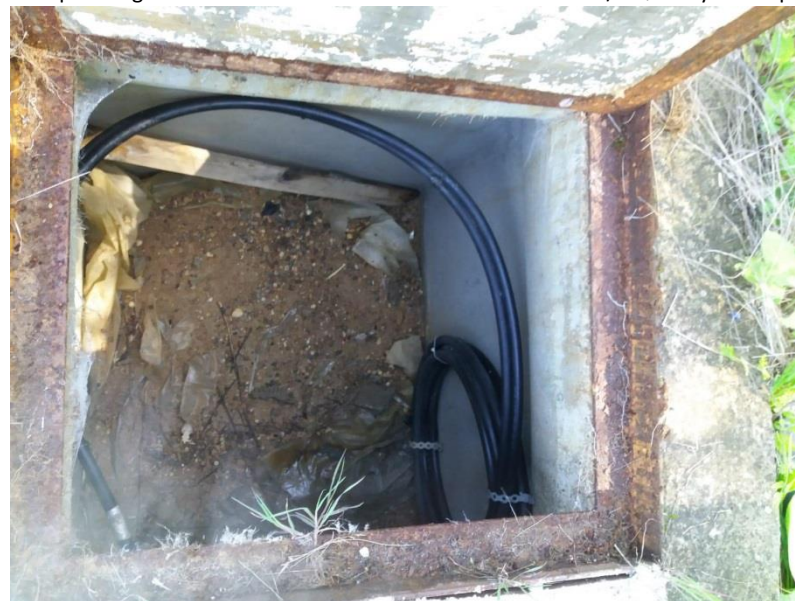
Interior arqueta fibra óptica anexa a pozo.
