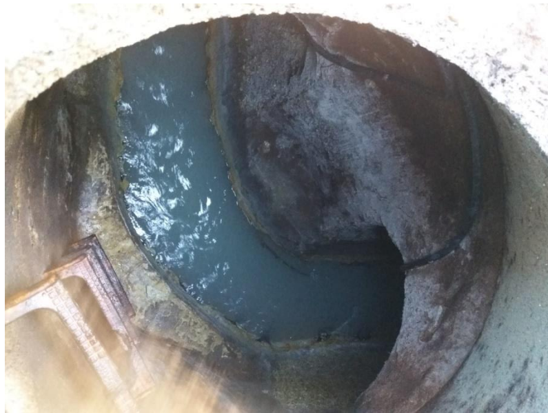
Interior pozo registro saneamiento. Conexión entre ovoide 1500/HAØ800 y fibra óptica.
