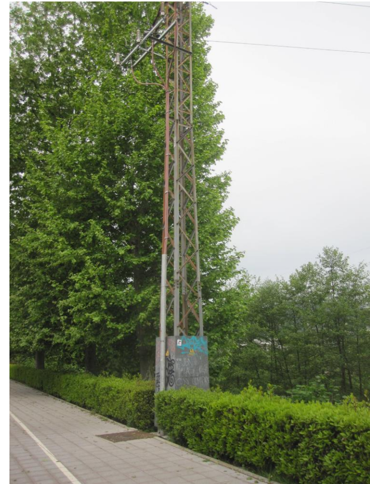
Torre de media tensión adyacente al paseo entorno al PK 0+600
